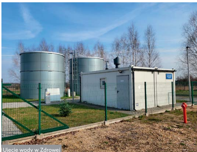
Ujęcie wody w Zdrowej
