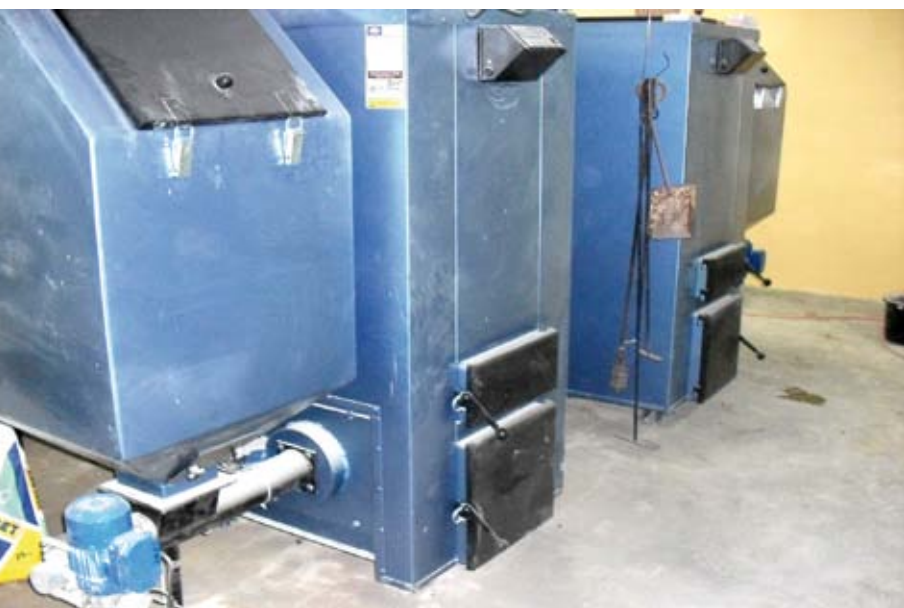
Nowoczesna kotłownia w szkole w Skrzydlowie
